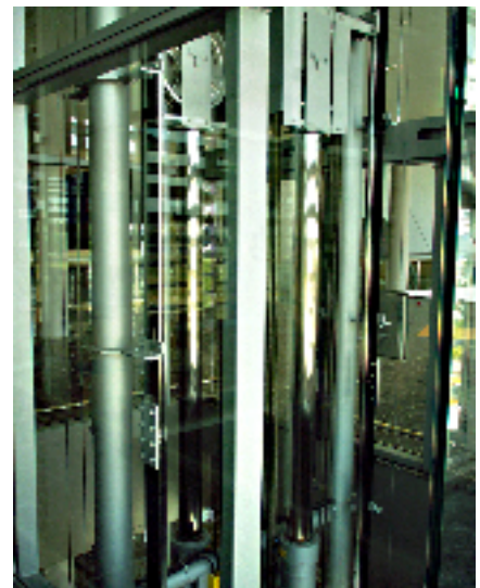
Panoramaaufzüge mit parallelstehendem einstufigem Heber
